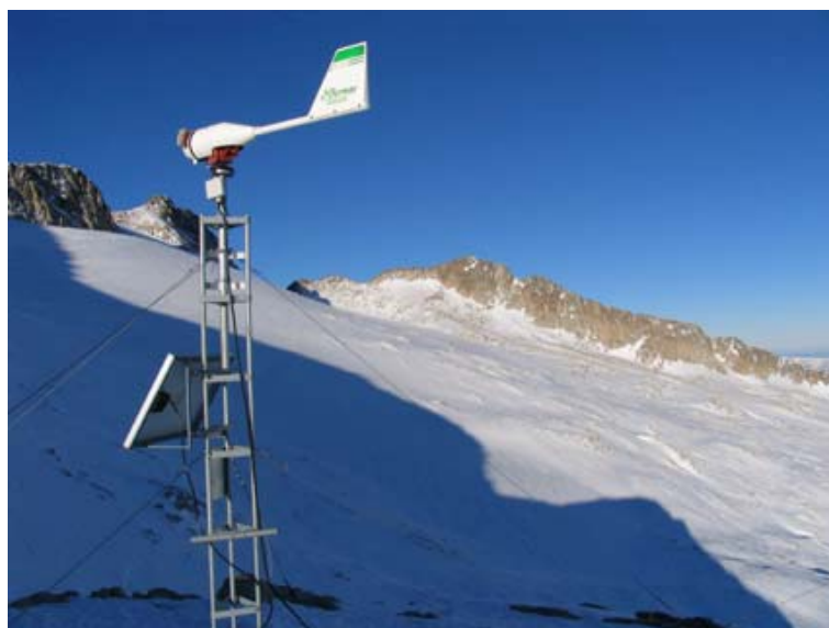
Fig 3 : torre de alimentación eléctrica.
